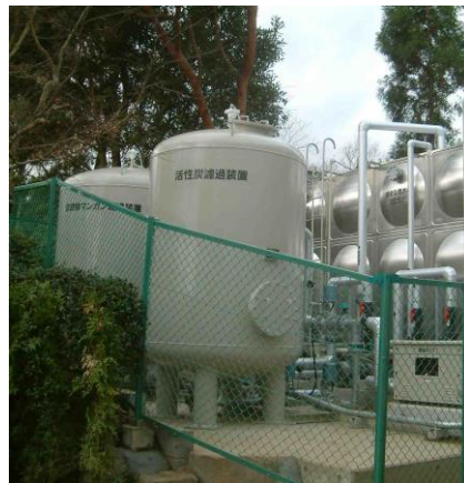
地下水浄化システム
