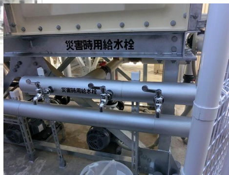
災害時用給水栓
