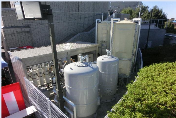
地下水浄化システム
