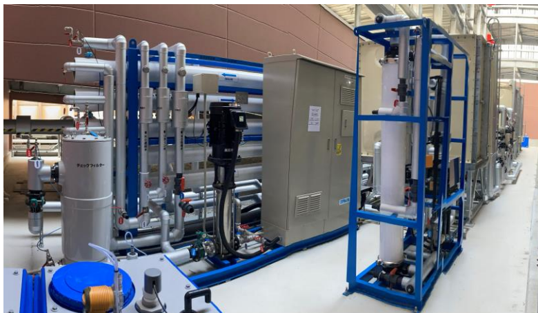
地下水浄化システム
