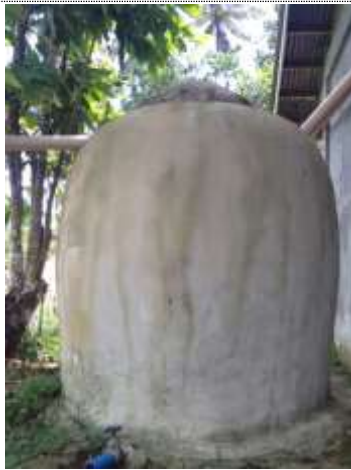
小学校の雨水貯留タンク
