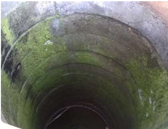
浅井戸の内部は汚れている
