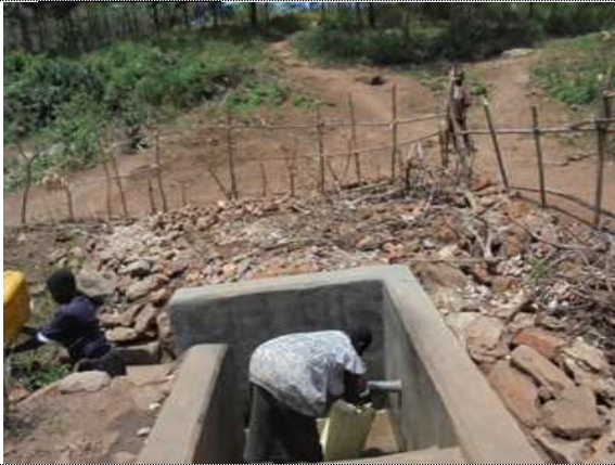
修繕されたアリモの給水設備から水を汲む住民
