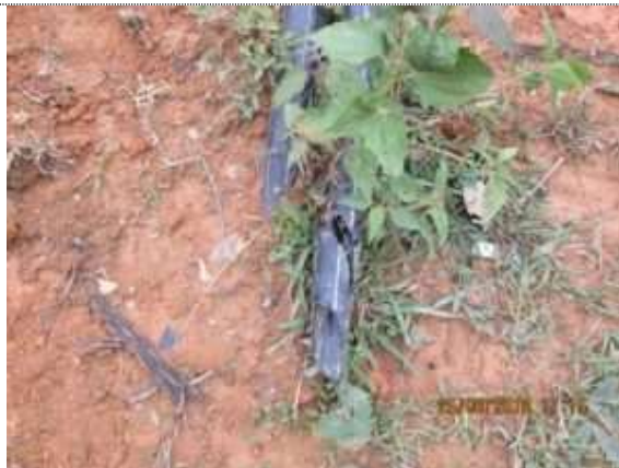
誰かに壊された給水配管
