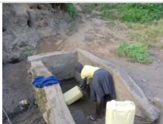
アメレンジュ・アヴブにある給水設備
