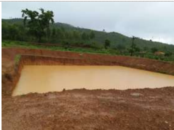
2016 年に建設した雨水貯留設備（雨期）
