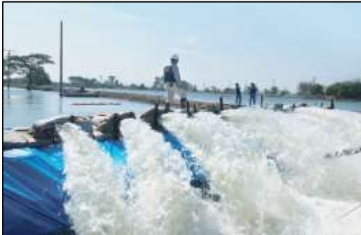
2011（平成23）年 タイ チャオプラヤ川 復興の立役者、タイで日の丸を背負った 排水ポンプ
