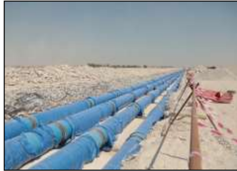
2014（平成26）年、カタール 海水淡水化プラントからの送水管
