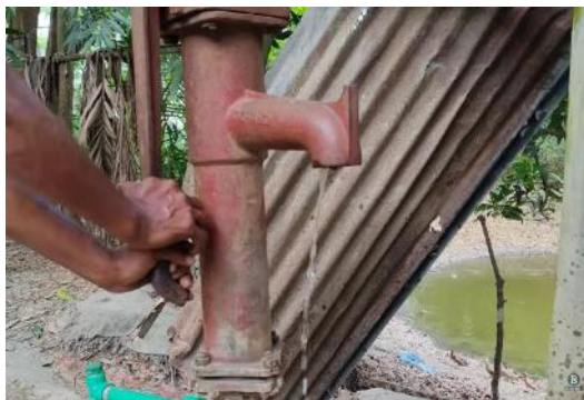
地下水位が低下して、井戸水の供給は不安定となった
