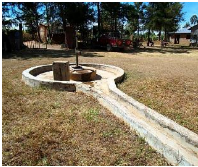
診療所内の破損して使用できない井戸
