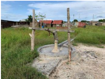
井戸の破損により、ボマ全体が水の危機となった
