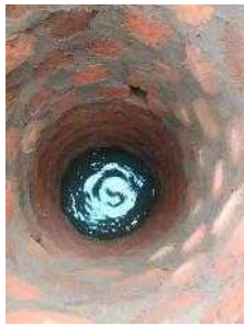
側壁のレンガ防護
