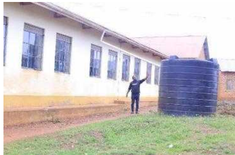
Rwenjeru小学校校舎と破損した貯水槽
