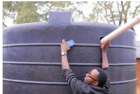
左手付近にヒビあり。本体に穴を空け、雨樋からの横走り管を間に合わせ接続している。
