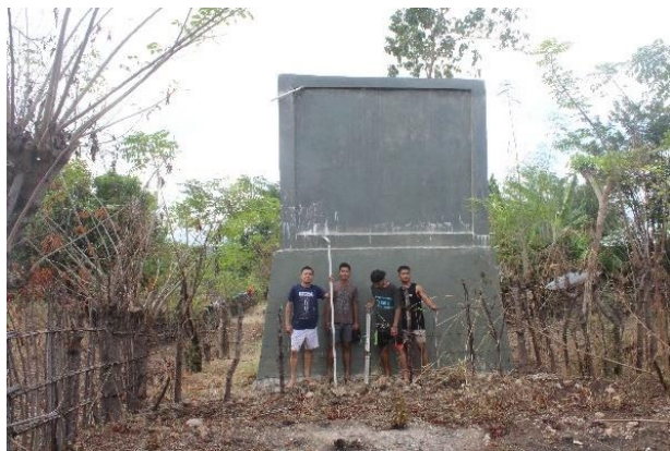
枯草に囲まれた水がない貯水槽
