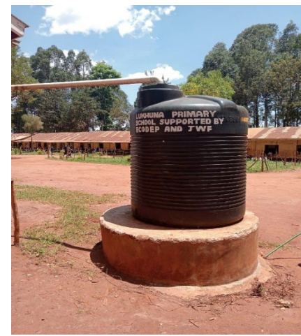
Likhuna小学校の雨水貯留タンク2023
