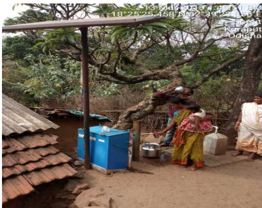
太陽光発電による飲料水濾過システム
