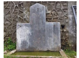
破損した給水設備
