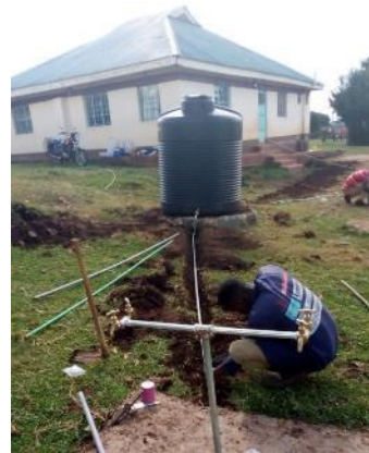
雨水貯留タンクと 手洗い器の配管接続
