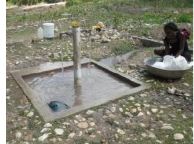
水が流れ続ける古い給水設備 (乾季・プロジェクト実施前)
