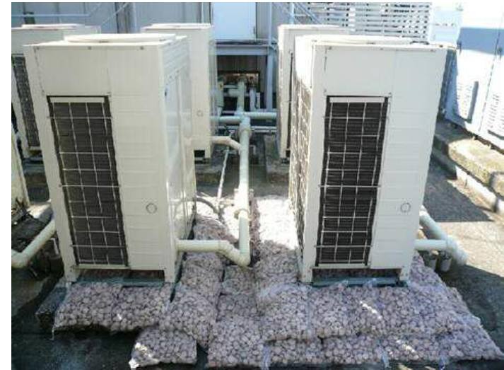
空調室外機周辺
